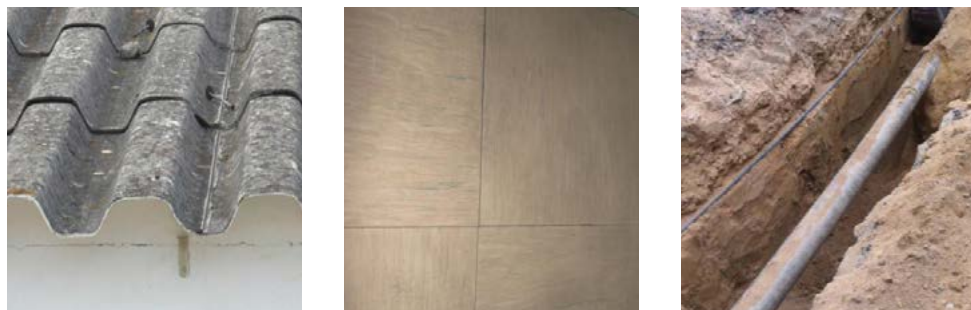
Figura 4 – Amianto não friável (fibrocimento em coberturas, pavimentos vinílicos e condutas de abastecimento de água).
